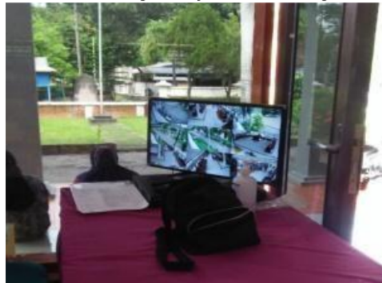
Foto 2.3 Layar Monitor CCTV
