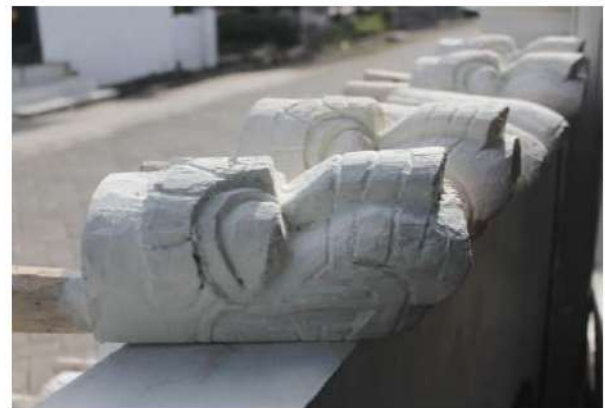
Gambar 4. Sebelum dilakukan pengecatan
